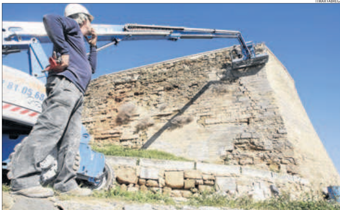
Les obres de consolidació d'un tram de muralla sota la Llengua de Serp, al Turó de la Seu Vella.
