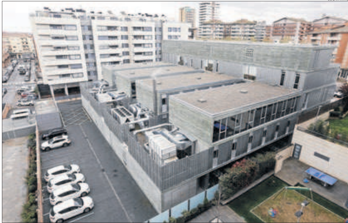
Vista del CAP d'Onze de Setembre amb els equips de climatització adossats a l'edifici.
